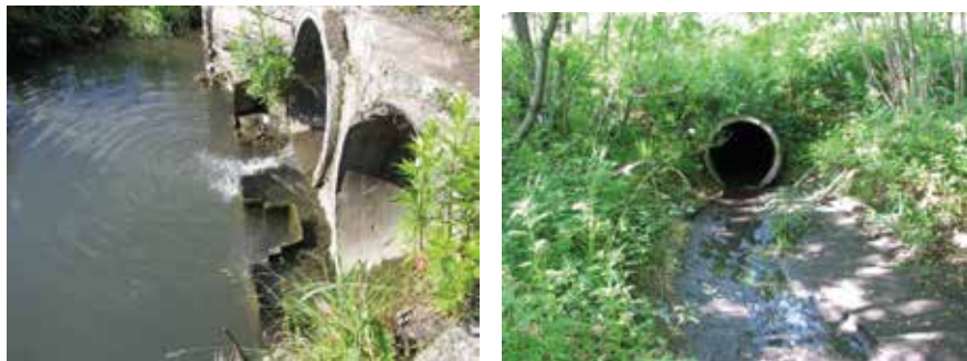
Рис. 2. Поступление загрязненных вод в северном районе озера
