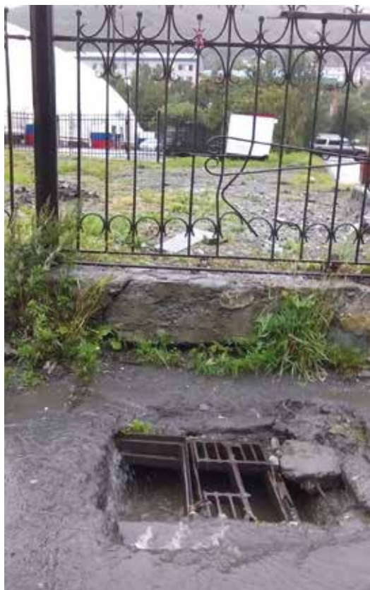
Рис. 3. Фотография поврежденной решетки колодца дождевой канализации по ул. Набережная в районе озера Култучное 12.09.2016 года (фото авторов).
